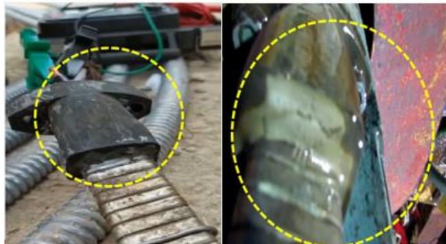
Gambar 1. Kerusakan Pot Head bocor pada sumur Mudi B#17
