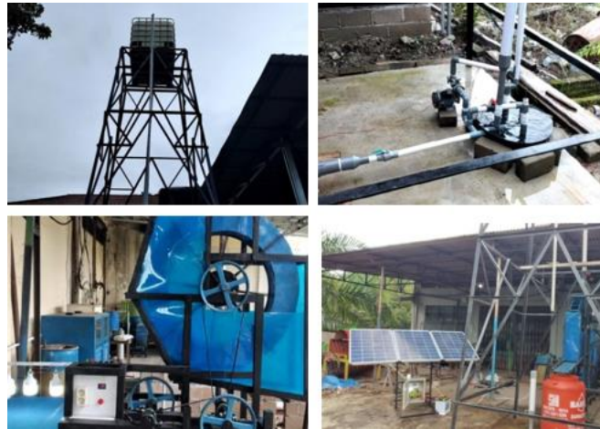
Gambar 5. Realisasi pembangkit listrik hybrid berbasis energi matahari dan energi hidro
